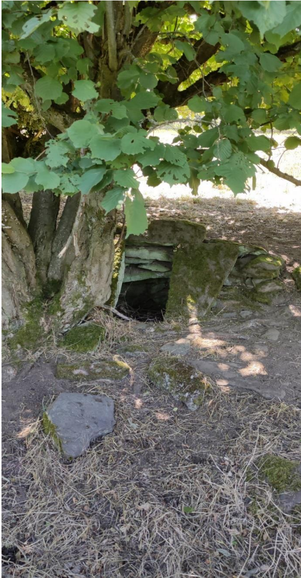
Abbildung 7) Hohlraum im Boden
