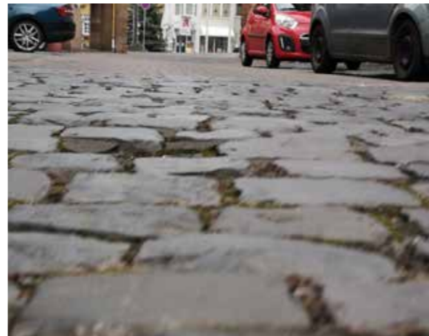
Der Blick aufs Detail zeigt die Probleme für eine barrierefreie Gestaltung.
