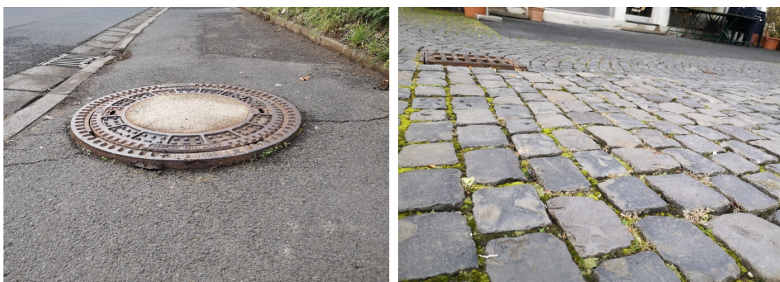
Abbildung 18: herausstehende Schachtdeckel in der Bahnhofstraße links und auf dem Marktplatz rechts als Hindernis im Untersuchungsgebiet
