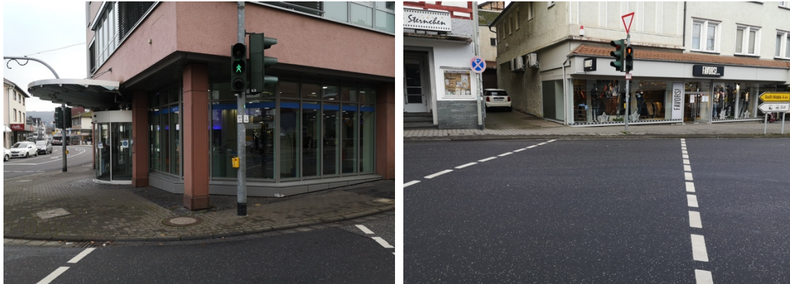
Abbildung 8: keine Absenkung des Bords (links) und leicht abgesenkter Bordstein (rechts) an der LSA
